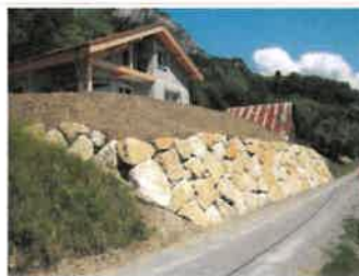
Exemple d'enrochements interdits
