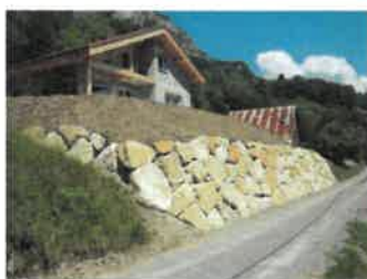
Exemple d'enrochements interdits
